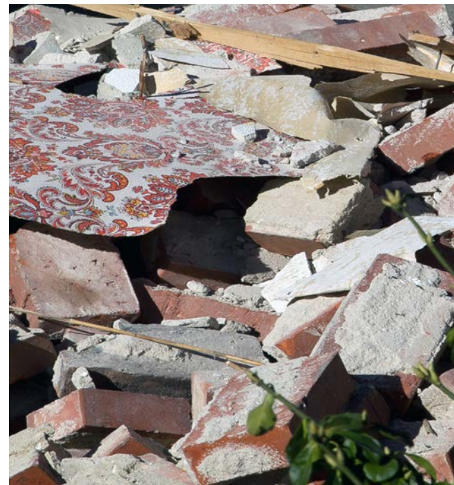
Det er vigtigt, at så mange mursten som muligt er hele, når huset er revet ned, så de kan renses og bruges i et nyt byggeri. Foto: Steen Don
